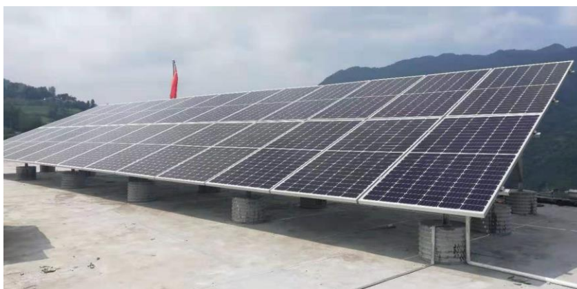
图为建设完成的光伏电池板阵列
